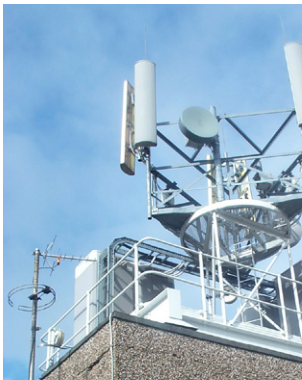
Figur 10.1 – Sektorantennerna för mobiltelefoni och en mikrovågsantenn på taket till lyftverkshuset
