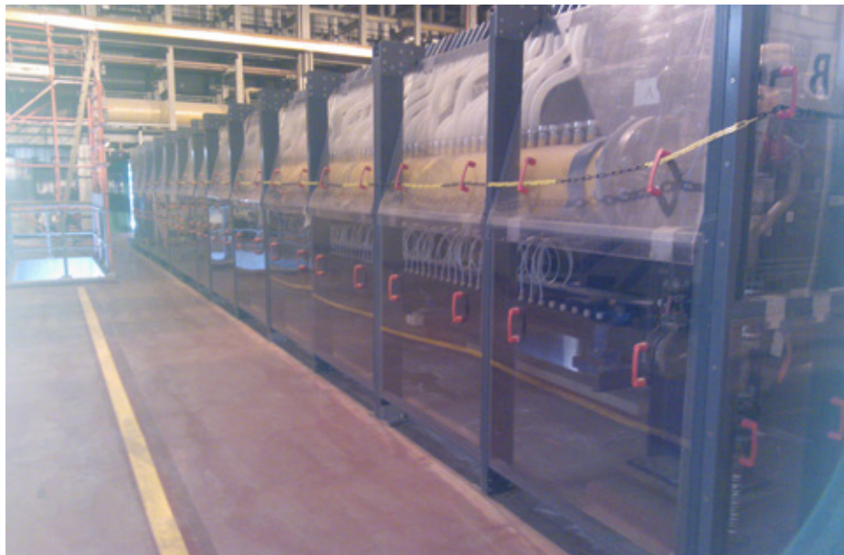
Figur 3.1 – Elektrolysörer i cellrummet
