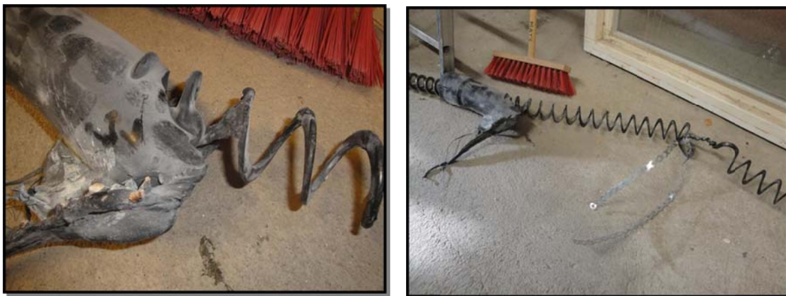
Bild 5 Rester av nedsmält transportrör och söndervriden pellets skruv. Felet orsakade brand som kunde släckas innan större skada uppstod. (Foto U. Svedberg).
