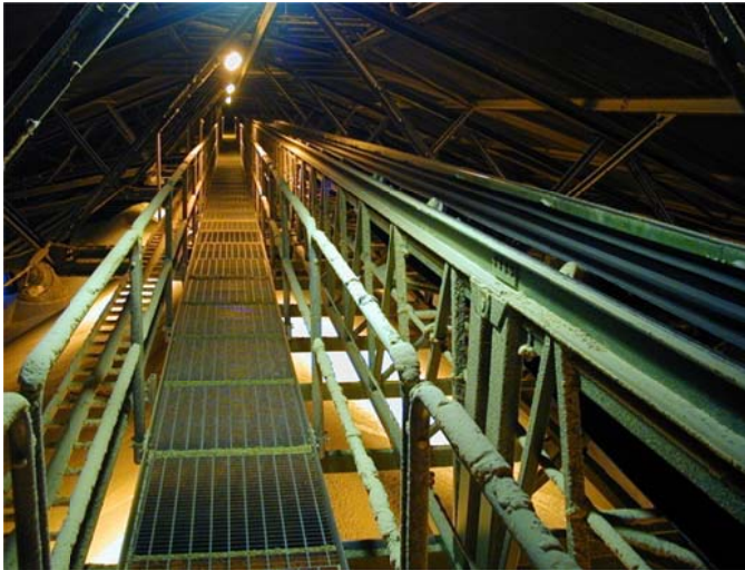
Bild 1 Servicebrygga ovan pelletstack i planlager.
