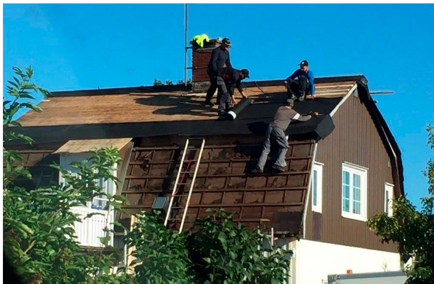
Bild – Arbetsmiljöverket. Byggarbetare arbetar på tak utan fallskydd.
