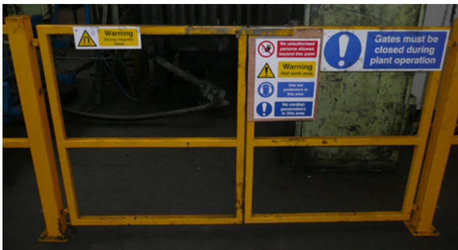
Figur 9.1 – Exempel på ett enkelt löstagbart skydd som används för att begränsa åtkomsten till ett starkt magnetfält I detta fall är skyddet inte låst utan kompletteras av varningssignaler och organisatoriska åtgärder
